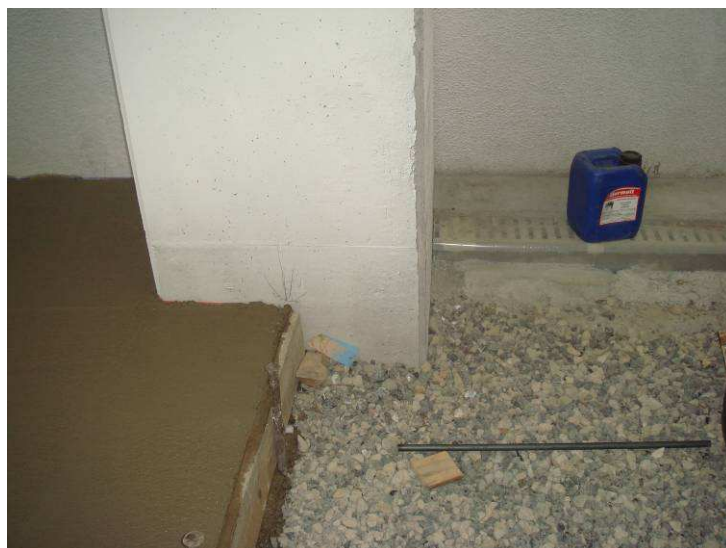
Figura 3.15. Particolare della zona di connessione tra la pavimentazione ed il pilastro per edifici industriali
